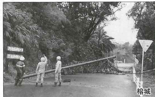
（台風21号）道路に横倒しとなった電話柱
