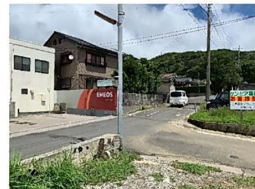
点検箇所②市道 市道 西町上之原線 横断歩道が消えて薄くなっている。通学路であり交通量も多いため引き直してほしい。
